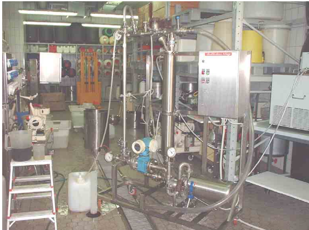
Abb. 52: Ultrafiltrationsanlage im Technikum der BOKU-Wien (Foto: Kornberg Institut)
